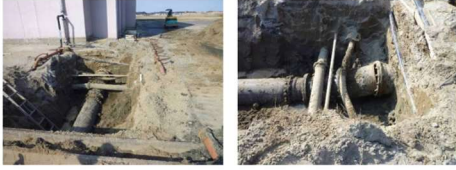
写真 10.5-8 取水ポンプ機の管路取り合い部 写真 10.5-9 取り合い部の継手の漏水
