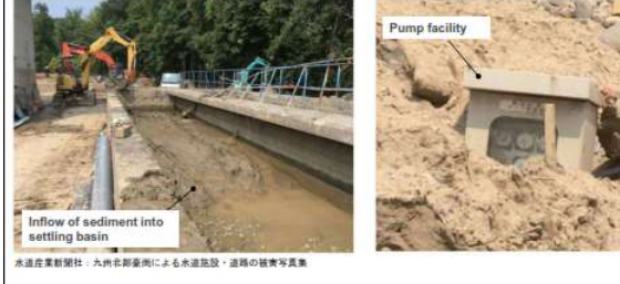
水道企業新聞社・九州北部豪雨による水道施設・道路の被害写真集
