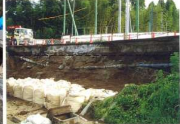
日本水道新聞社：平成16年台風による水道施設の被害写真集
