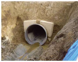
Fig. 42 スラストブロックの破損 (矢吹南工区) Damage to thrust block at Yabukimami subsection
